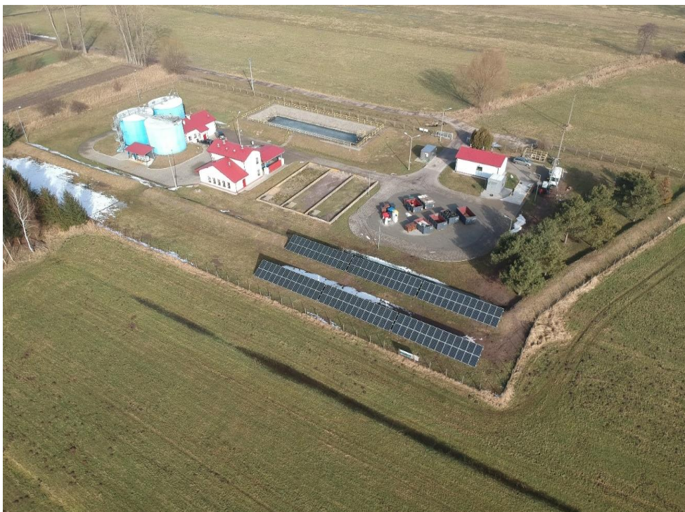
Instalacja fotowoltaiczna Oczyszczalnia ścieków
